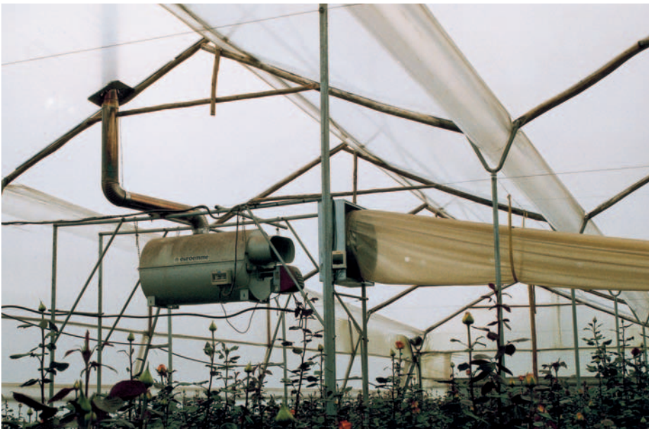
Kalte Nächte am Fuß des Vulkans Cotopaxi: Ölbeheizte Lüfter mit Folienschläuchen halten La Victoria Roses frostfrei
